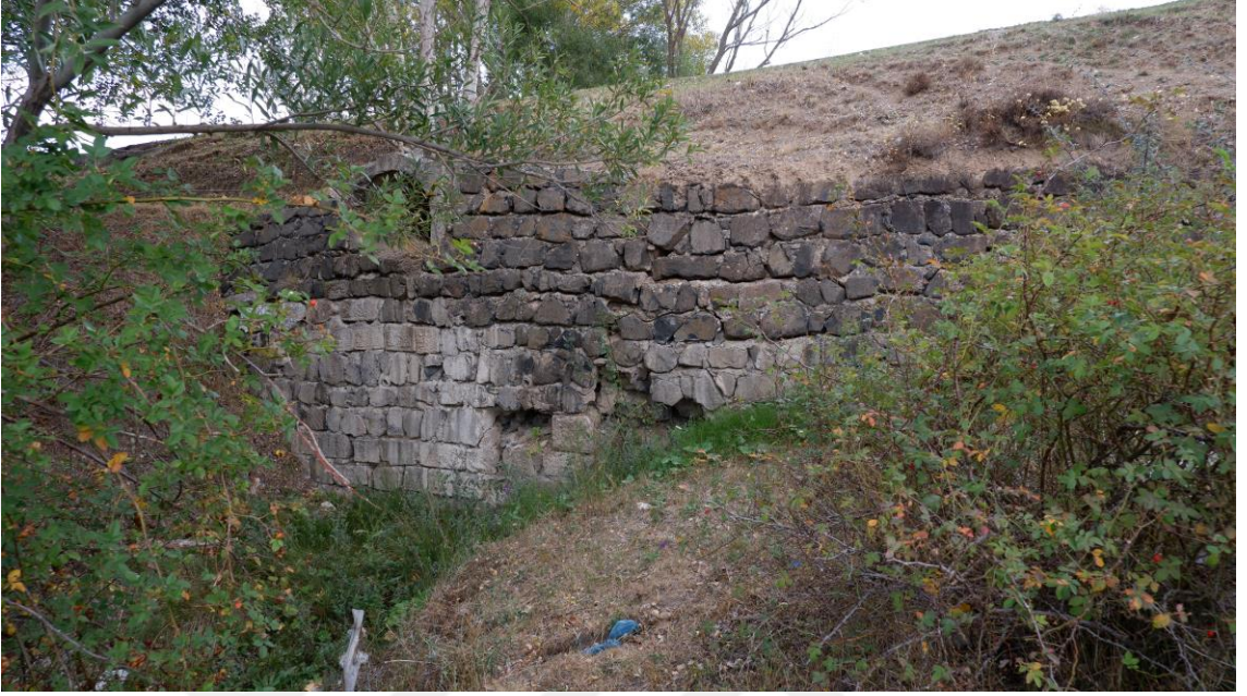
Foto 19. Akören Köyü Yolundaki İstinat Duvarı ve Tarihi Köprü (16.09.2021).
