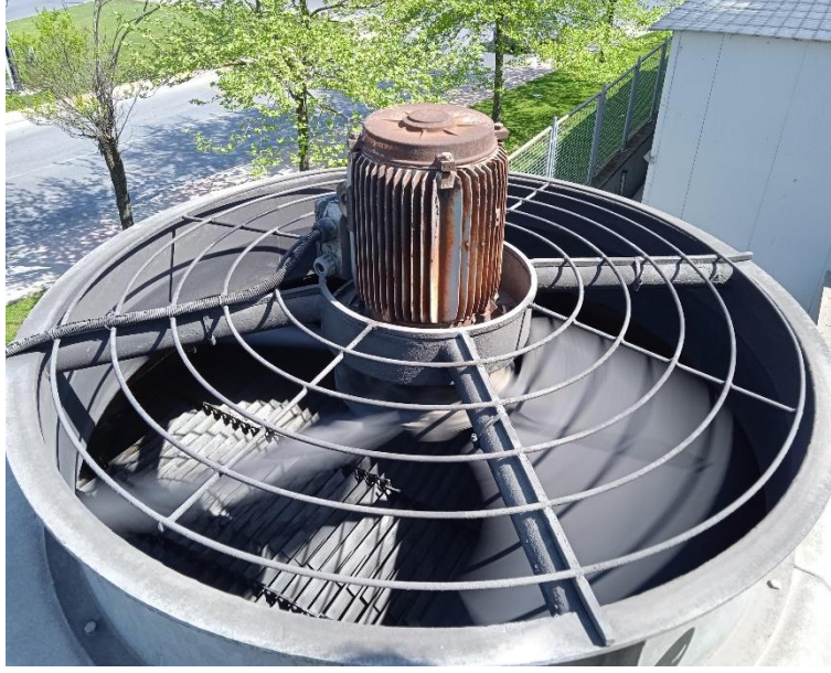
Şekil 51: Soğutma Kulesi 2 Fan
