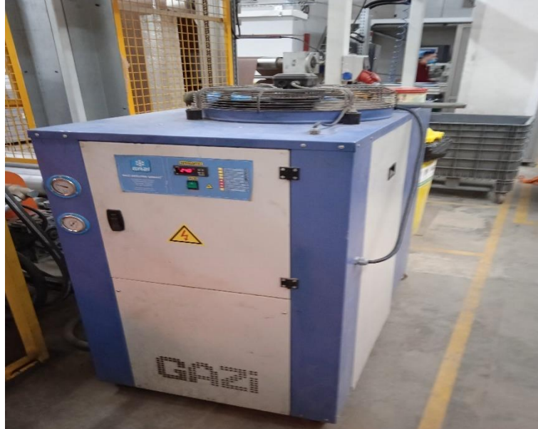
Şekil 32: Gofraj 3 Chiller Genel Görüntü
