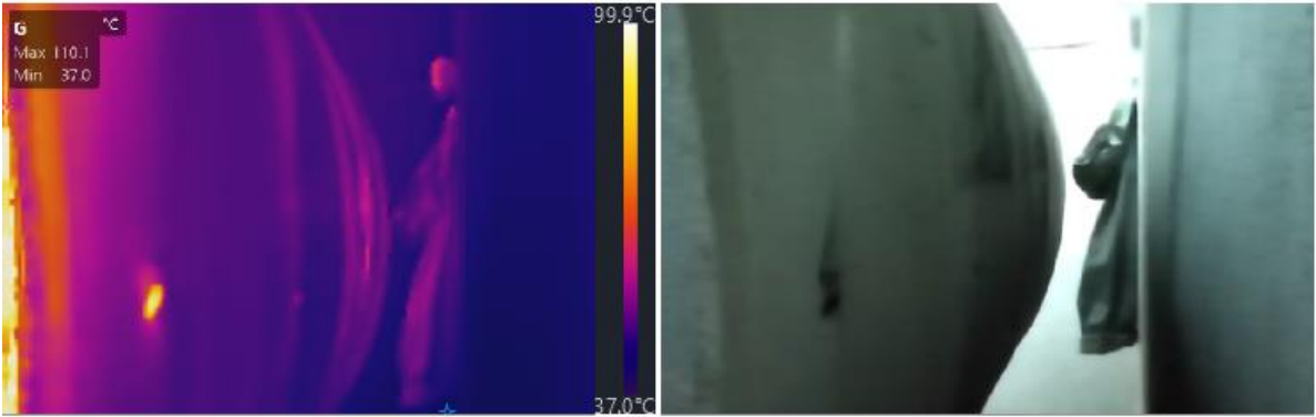
Şekil 25 64142 Buhar Kazanı Sağ Yüzey
