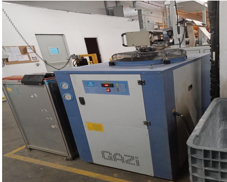
Şekil 30: Gofraj-1 ve 2 Chiller Genel Görüntü
