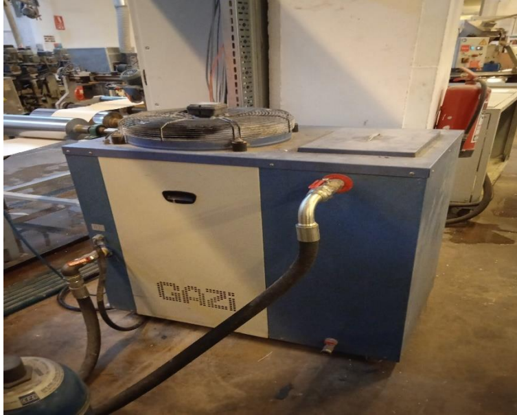
Şekil 28 : KF-6 Chiller Genel Görüntüsü
