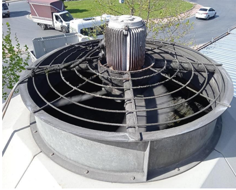
Şekil 50: Soğutma Kulesi 1 Fan
