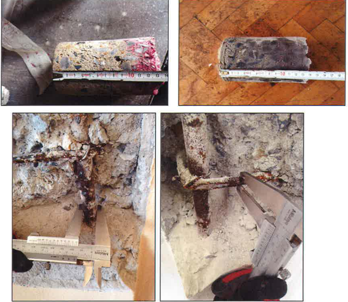
Şekil 4:Binanın çeşitli katlarındaki kolonlarında karbonatlaşma ve donatıdaki korozyon
