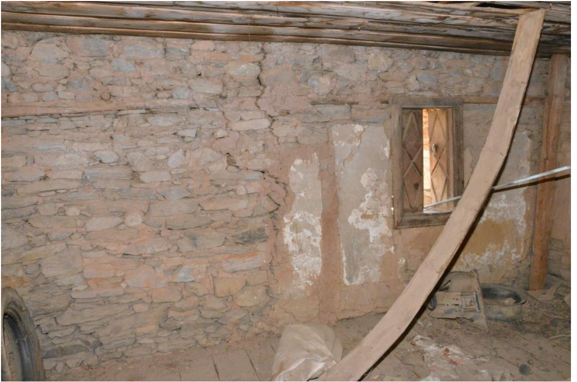
Fotoğraf 42- Yapının iç kısmında kalan sıva izleri
