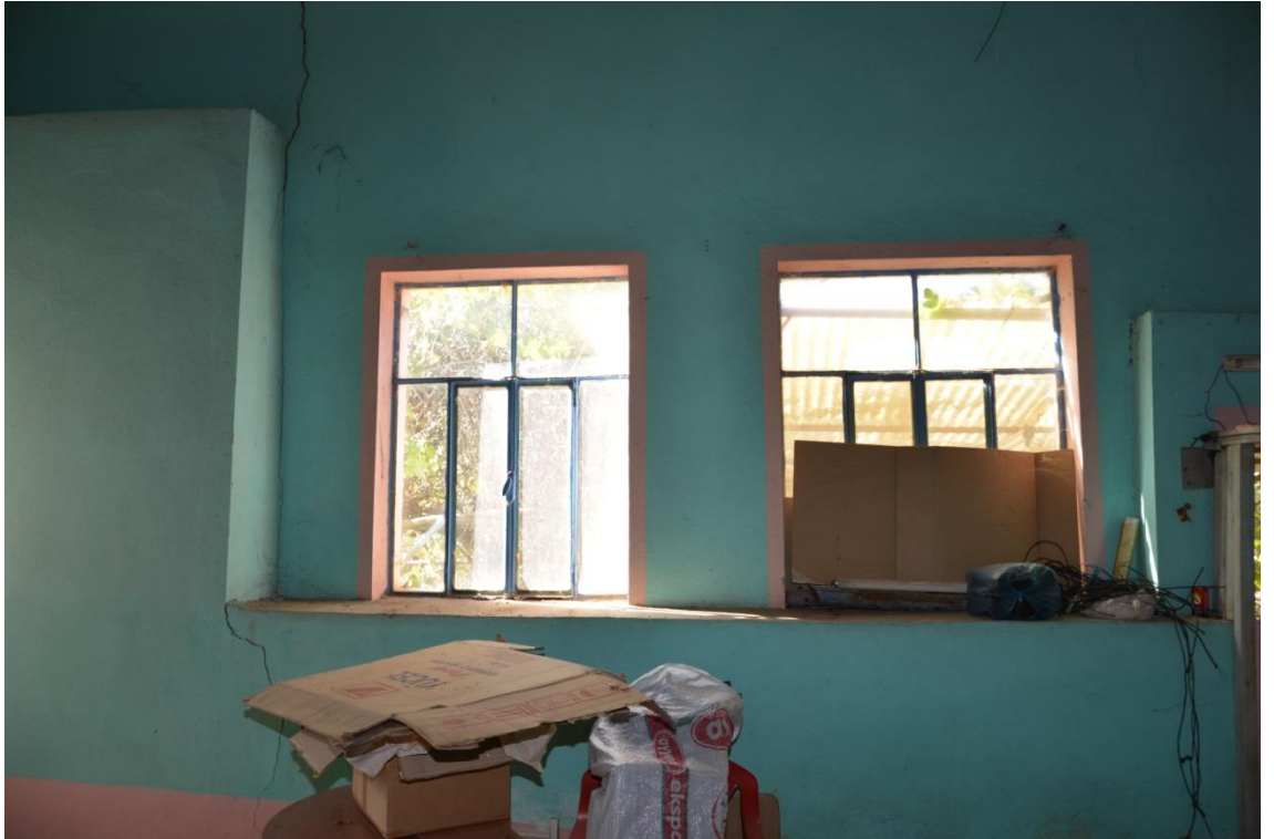
Fotoğraf 4- Yukarı Cami'nin sonradan kapatılmış olan son cemaat yerinin betonarme duvarı
