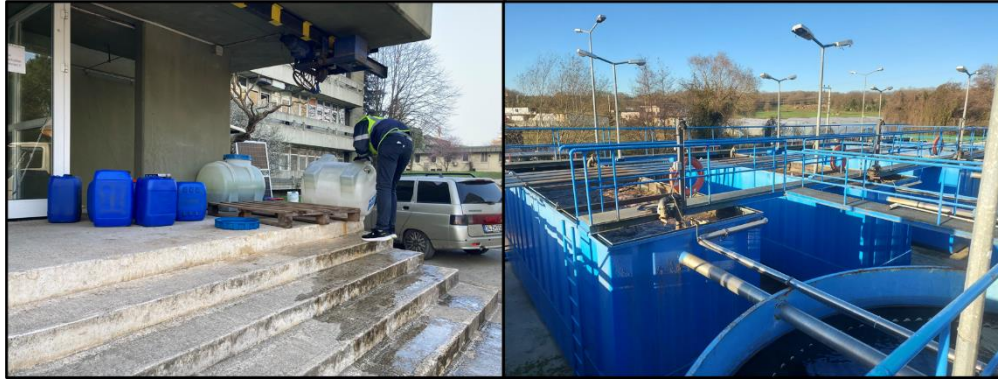
Şekil 3. 1 Atıksu arıtma tesisi ve atıksu temin çalışmaları
