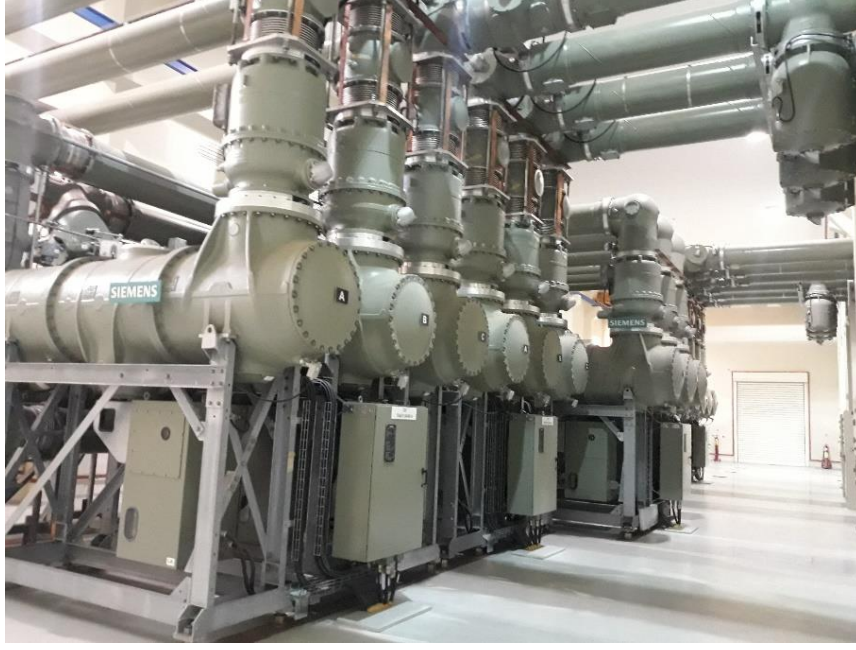
Resim 8. Gaz İzoleli Şalt Sahası
