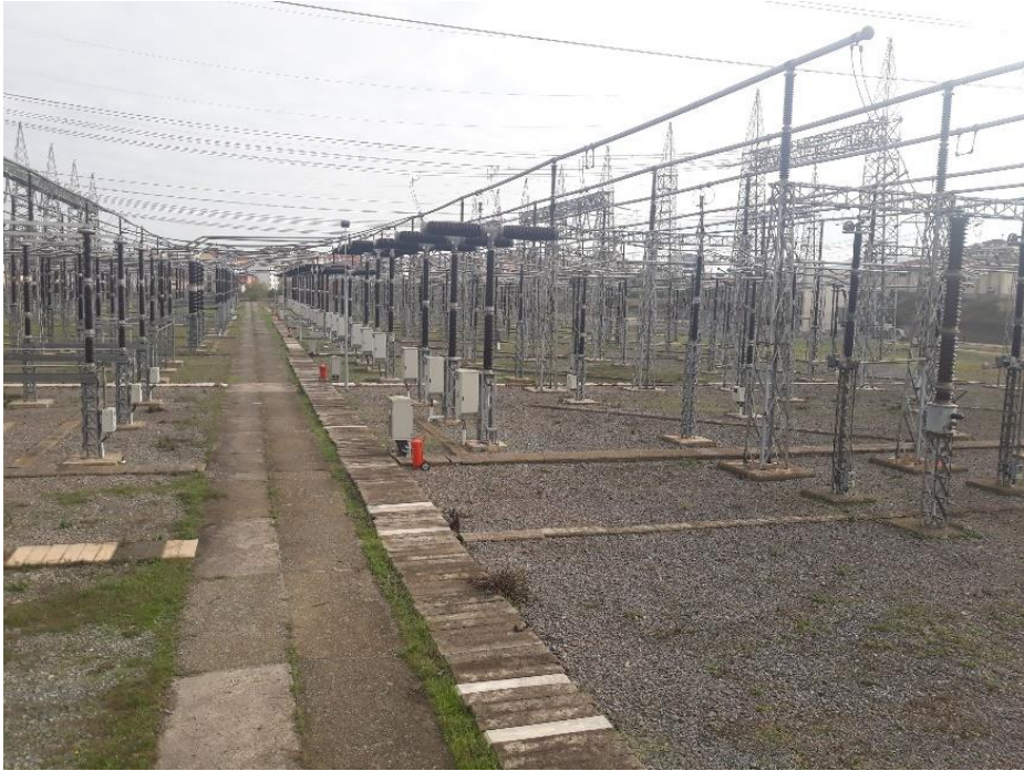
Resim 7. Açık Şalt Sahası
