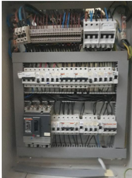
Resim 38. Trasnformatör Merkezinde Bulunan Kaçak Akım Rölesi Olmayan Elektrik Panosu
