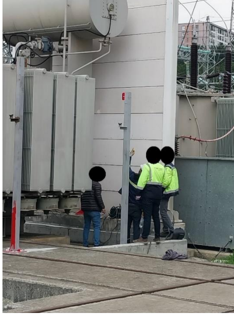
Resim 32. Açık Şalt Sahasında Eksik KKD Kullanımı Yapan Kişiler
