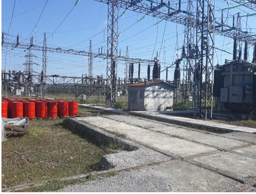
Resim 40. Açık Şalt Sahasında Bulunan Boş Variller
