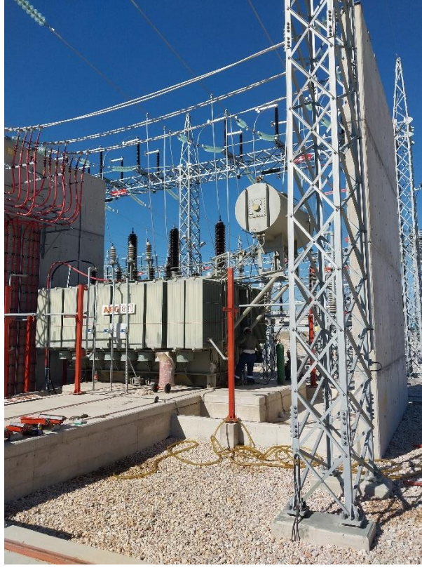
Resim 50. Transformatör İçin Otomatik Yangın Söndürme Sistemi
