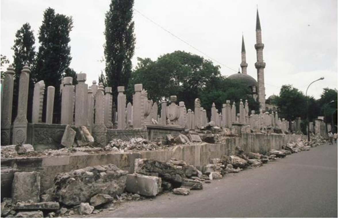
Şekil 95: Tamamen Yıkılan Duvarın Görünümü
