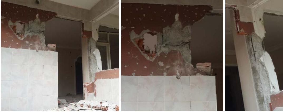
Şekil 41. A blokta iki köşe kolona verilen hafif hasarlar
