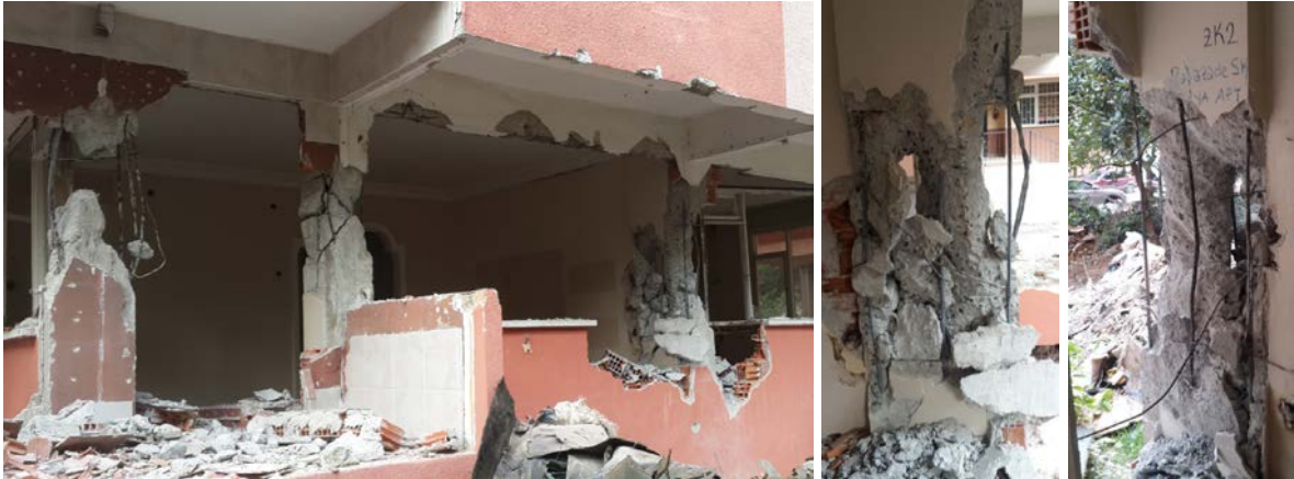
Şekil 54. A Blok Binasında Ağır Hasar – 2 durumu ve Ağır Hasarlı kenar kolon
