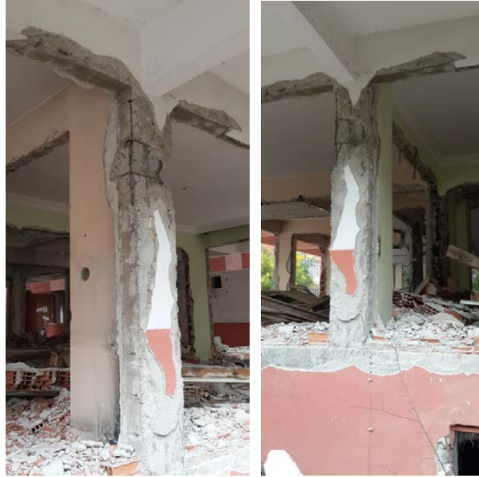
Şekil 60. B Blok Binasına Hafif Hasar – 2’de verilen kenar kolon hasarları
