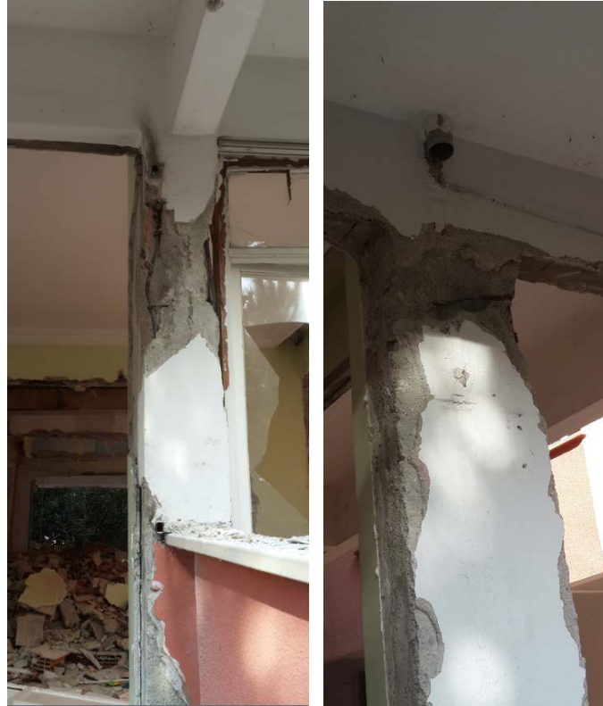
Şekil 57. B Blok Binasında iki köşe kolona verilen hafif hasar
