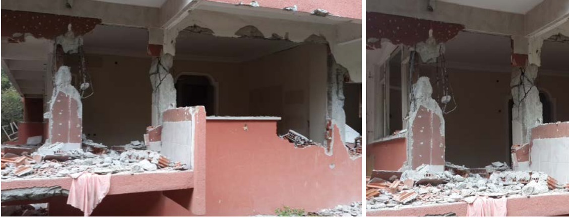
Şekil 50. A Blok Binasına Ağır Hasar – 1’de verilen köşe kolon hasarları
