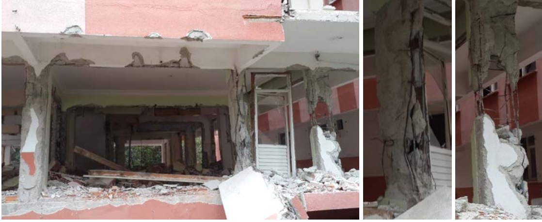
Şekil 66. B Blok Binasının Ağır Hasar – 1’de durumu ve hasar verilen köşe kolonlar
