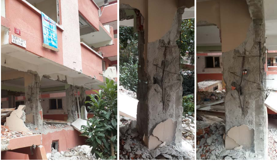
Şekil 69. B Blok Binasının Ağır Hasar – 2’de durumu ve hasar verilen kenar kolon
