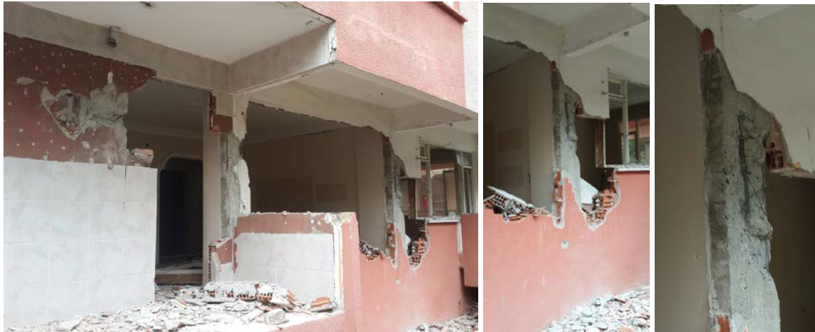
Şekil 44. A Blok Binasında üç kolona verilen hafif hasar ve üçüncü kolondaki hasar detayları
