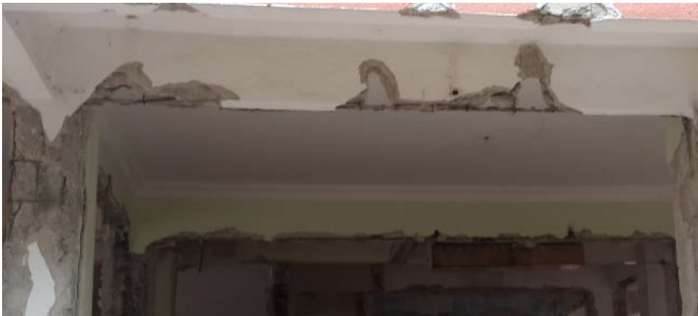
Şekil 63. B Blok Binasında Hafif Hasar – 3 için kirişe verilen hasar.
