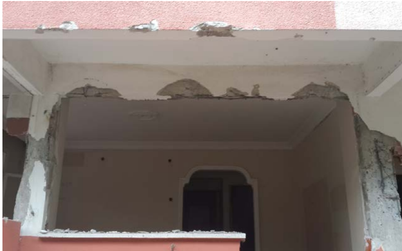
Şekil 47. A Blok Binasında hafif hasarlı kolonları birleştiren kirişe verilen hasar detayları
